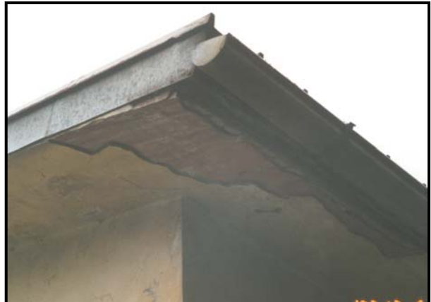
Gronda danneggiata e pericolante.
