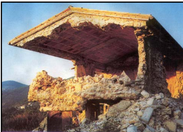
Danni provocati da una copertura pesante su murature di scarsa qualità per effetto del sisma.
