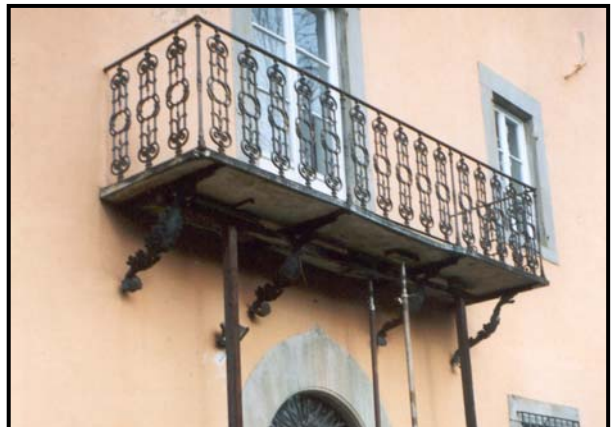
Balcone puntellato con pericolo di crollo su portone d'accesso all'edificio.
