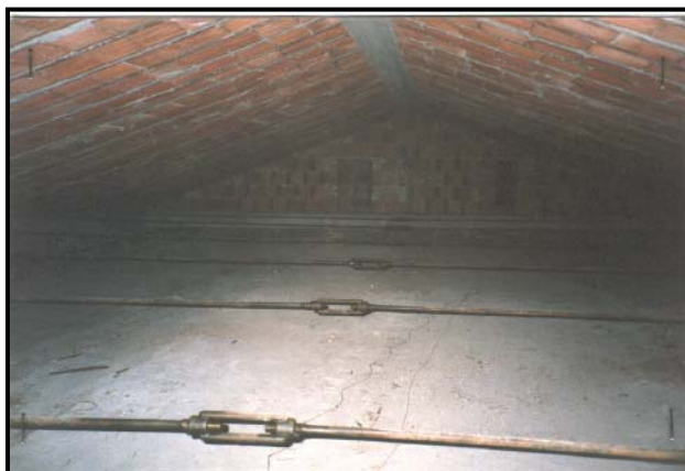
Copertura rigida con travetti in c.a. e pignatte disposti in senso spingente. La copertura è a spinta eliminata per la presenza di catene metalliche.
