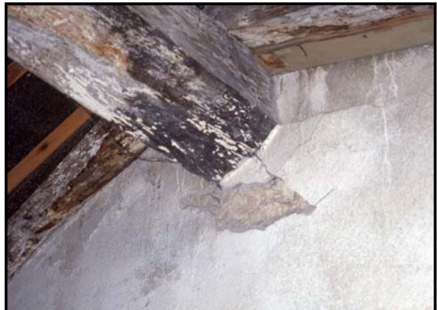
Danni provocati dal martellamento della trave di colmo.
