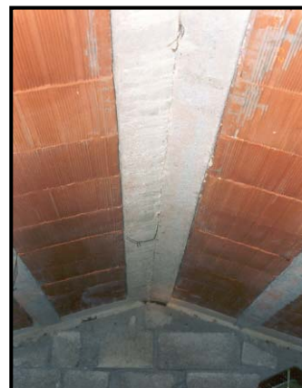
Copertura rigida con travetti in c.a.p. e pignatte disposti in senso non spingente.
