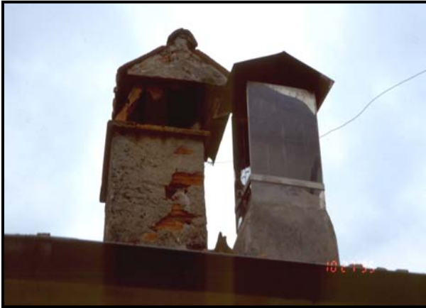
Comignolo mal vincolato alla copertura.
