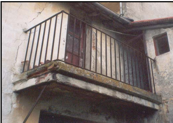
Balcone mal vincolato alla parete verticale.
